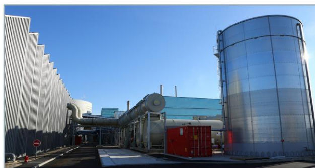
Réserve d'eau du réseau sprinklage : 9 m de diamètre 13 m de hauteur - 840 m 3
